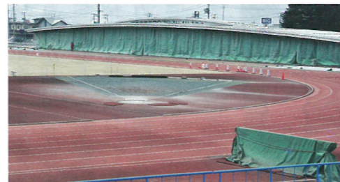
△あかねヶ丘陸上競技場。トラックのパイロン部分は穴が空いて使えないコースが出ている。
